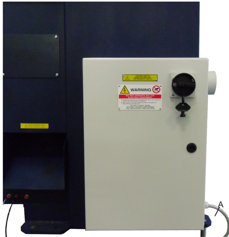
Figura 4.6.2 A – Dislocazione Pannello Elettrico
